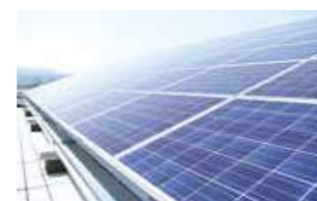
太陽光パネル
