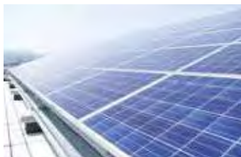
太陽光パネル
