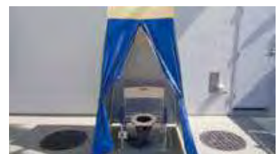
マンホールトイレ
