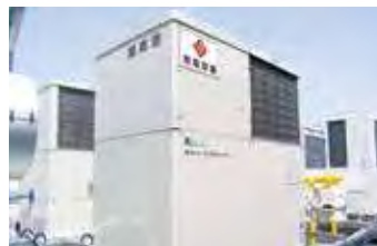
ガスコージェネレーションシステム
