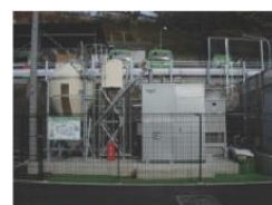
ペレット式空調屋外機
