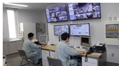
供給管理センター
