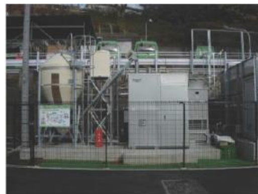
ペレット式空調屋外機
